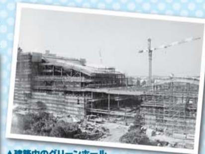
▲建築中のグリーンホール 1987年9月の着工から2年余りで完成しました。グリーンホールは、市内最大のホールとなりました。
